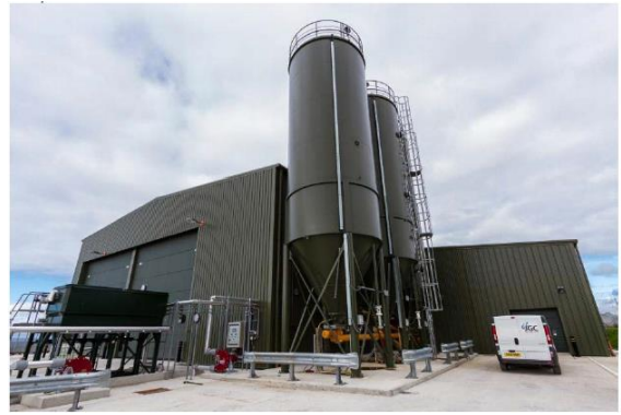
図4 グラウト材プラント全景
